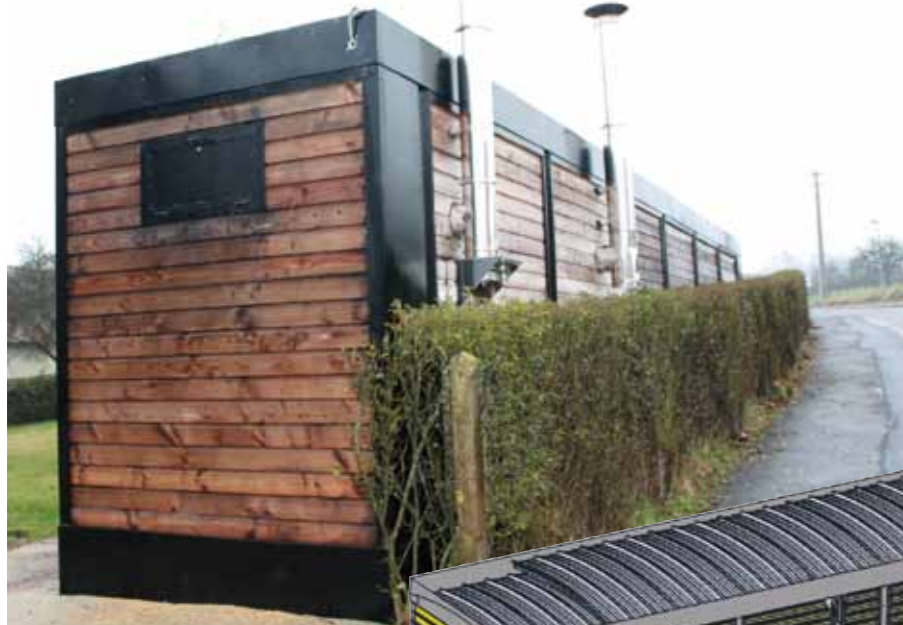
Local de la chaufferie d'où partent les tuyaux souterrains du réseau de chaleur alimentant les trois bâtiments communaux.
